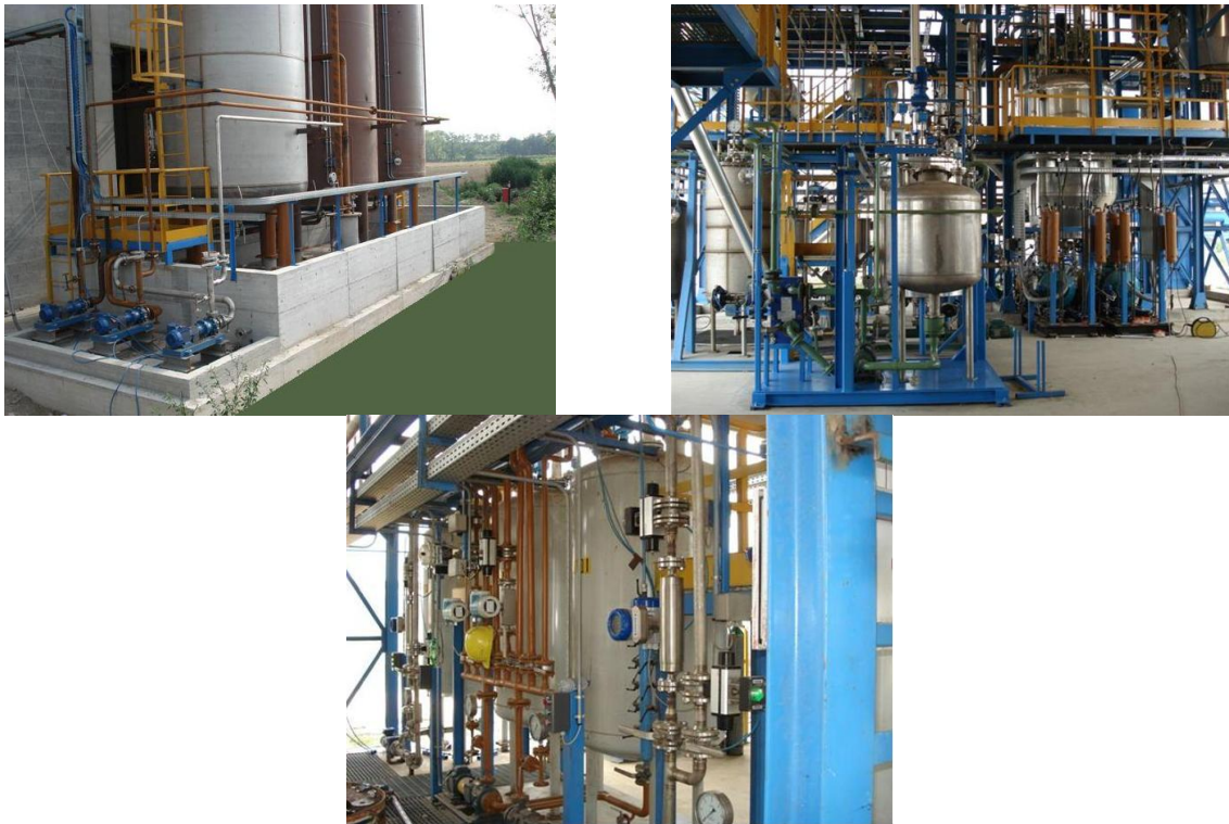
Рис. 3.9 – Зовнішній вигляд біодизельної установки ws-23
