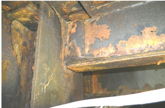
Рис. 3 – Результат корозійного износа металоконструкції МНЛЗ (перекрыття)
