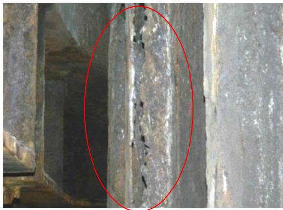
Рис. 1 – Результат коррозионного износа опоры поворотного стенда МНЛЗ
